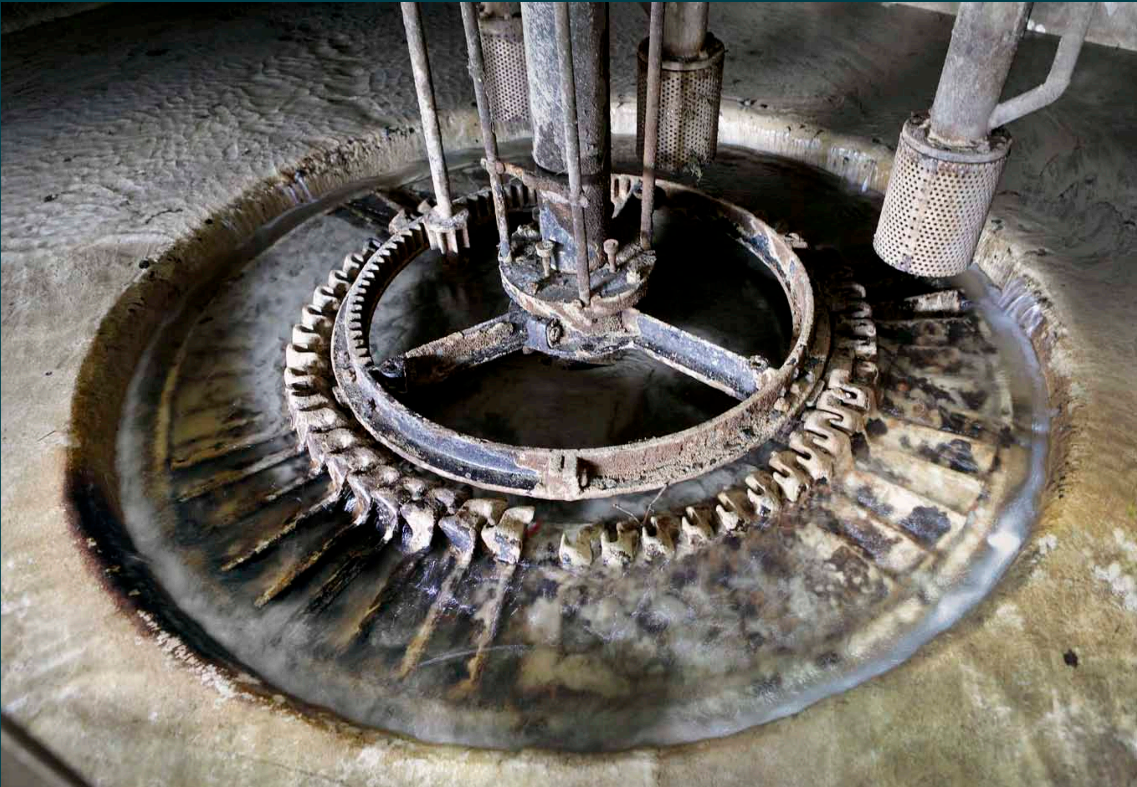
Charleval. Tissage de Transières. Turbine Fontaine d’une puissance de 500 000 kWh, en état de marche. Dès sa mise en activité, en 1856, le tissage de coton des frères Hitzinger, bénéficie d’un équipement de pointe : une turbine double pouvant fonctionner avec des débits variables. Eugène Armengaud, professeur au Conservatoire national des Arts et Métiers en fera l’éloge dans un ouvrage technique paru en 1858. Cette turbine est d’emblée complétée par une machine à vapeur. Grâce à leur force conjointe, ces deux moteurs entraînent les 312 métiers à tisser que compte alors l’usine.
