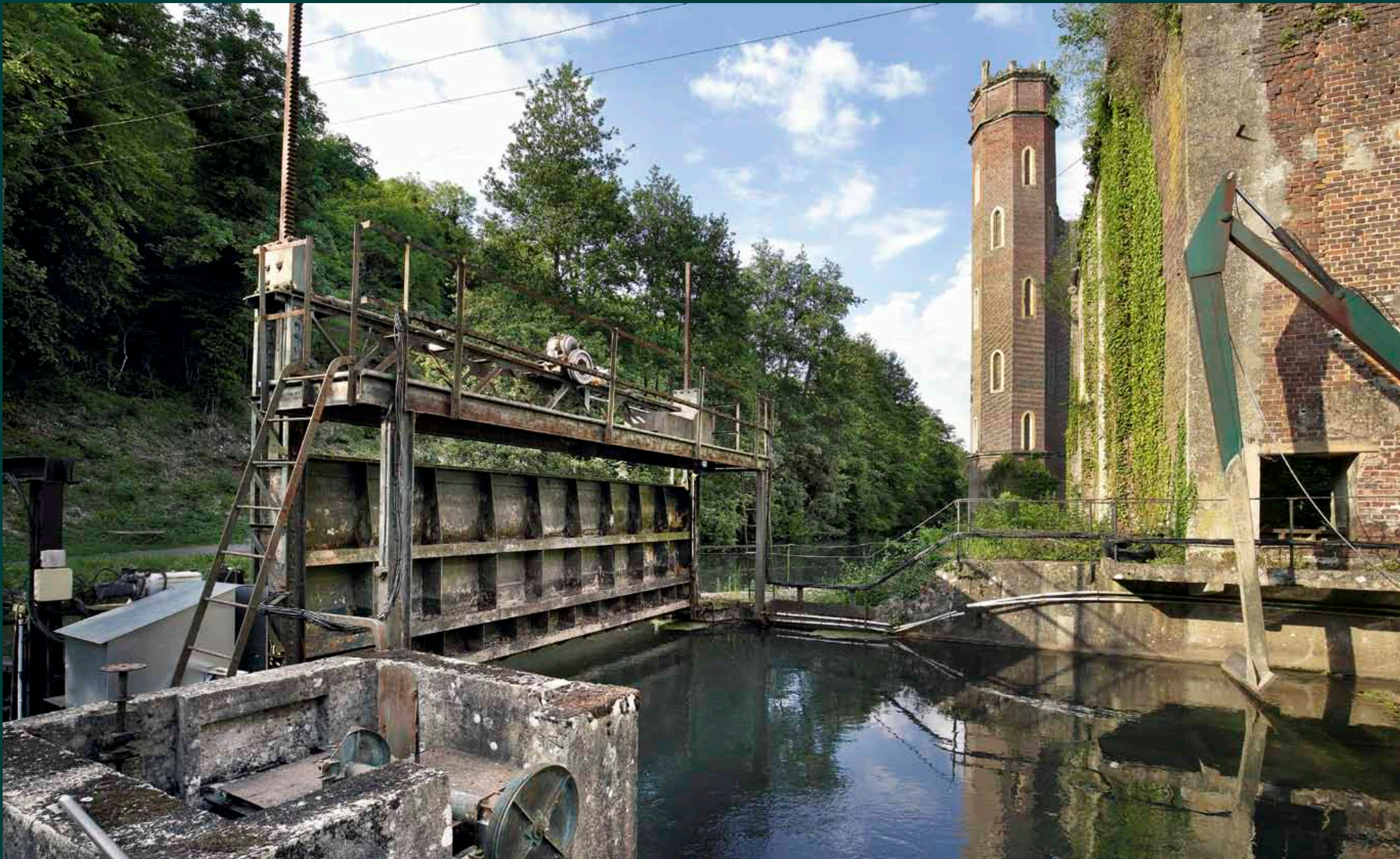
Canal d'aménée et vannes d'alimentation de la centrale hydroélectrique.
